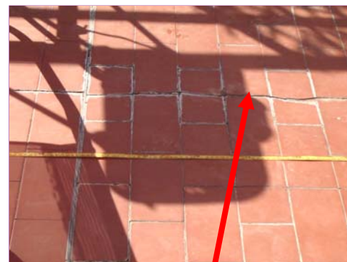
Terrasse AVIT - fissuration
